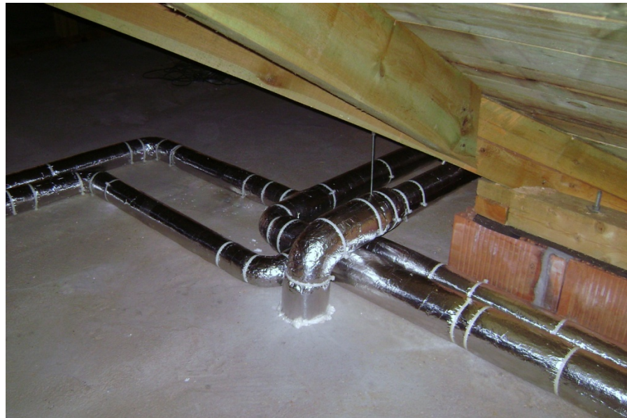
Kanały ułożone na poddaszu nieużytkowym domu parterowego. Po przejściu przez strop będą wentylować pomieszczenia na parterze.
