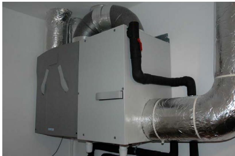
Zamontowany gruntowy wymiennik ciepła (z prawej) z rekuperatorem AERIS 550.
